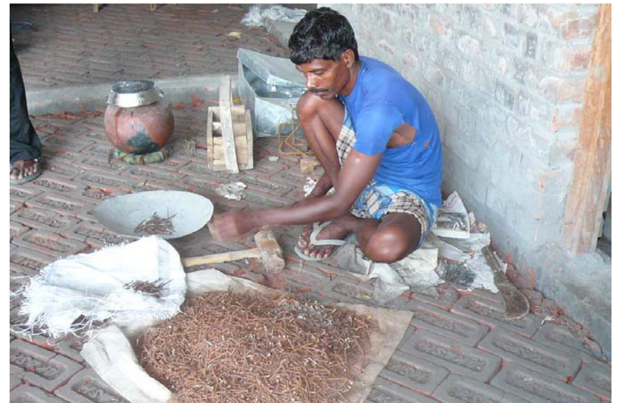
Die Nägel der Betonschalung werden nach dem Ausschalen gerade geklopft und anschließend wieder verwendet.
