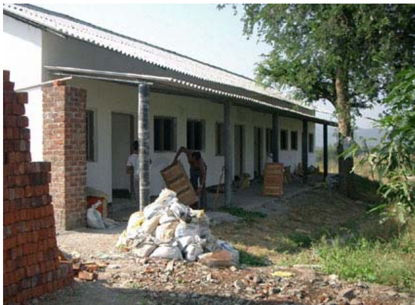
Wie allen Gebäuden auf dem Grundstück ist auch dem Personalhaus eine Veranda vorgelagert, welche die dahinter liegenden Räume vor Sonne und Regen schützt.
